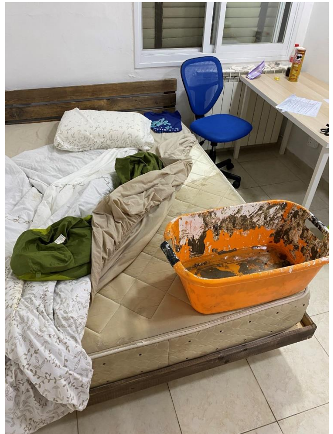
Wasser – nicht nur durch die Fenster, sondern irgendwann auch von der Decke (Foto: Marius Thomas)
